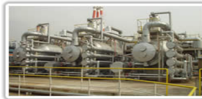
蒸気発生設備
