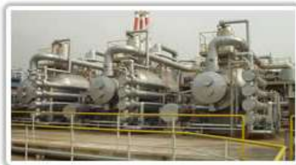
蒸気発生設備
