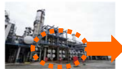
高効率熱交換器 入れ替えの例
