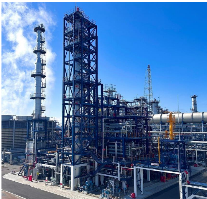
SAF製造プラント（コスモ石油 堺製油所）
