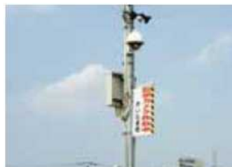
【市内に設置した監視カメラ】
