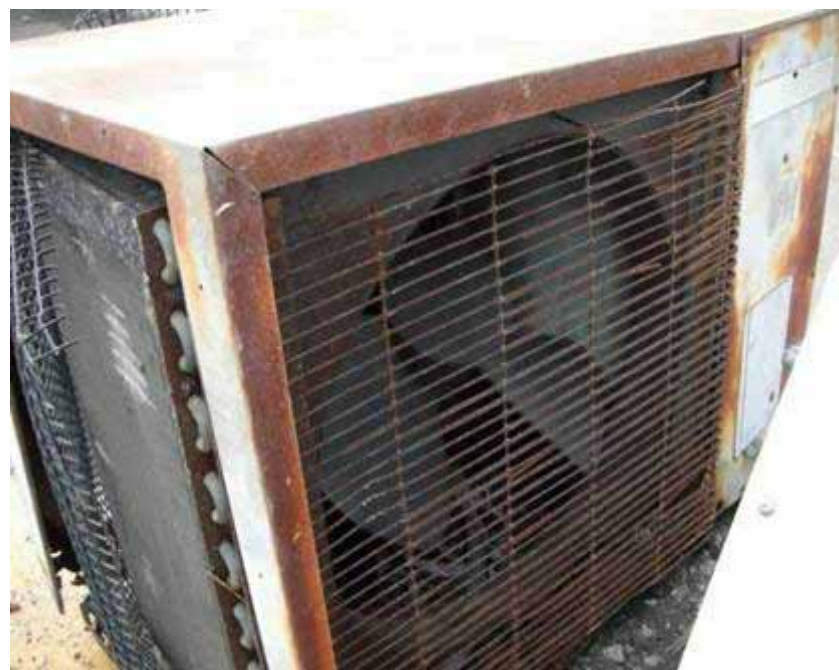
【著しくさびが付着した室外機】
