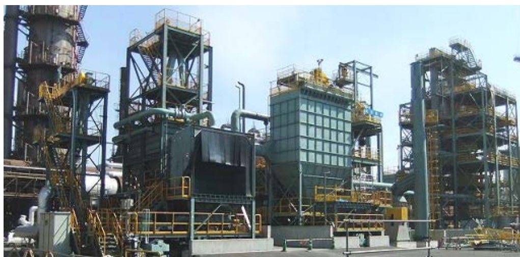
図 3-36 パイロットプラント全景
