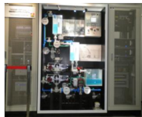
⑤下水・排水プラント
