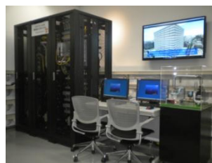
③ビル制御システム
