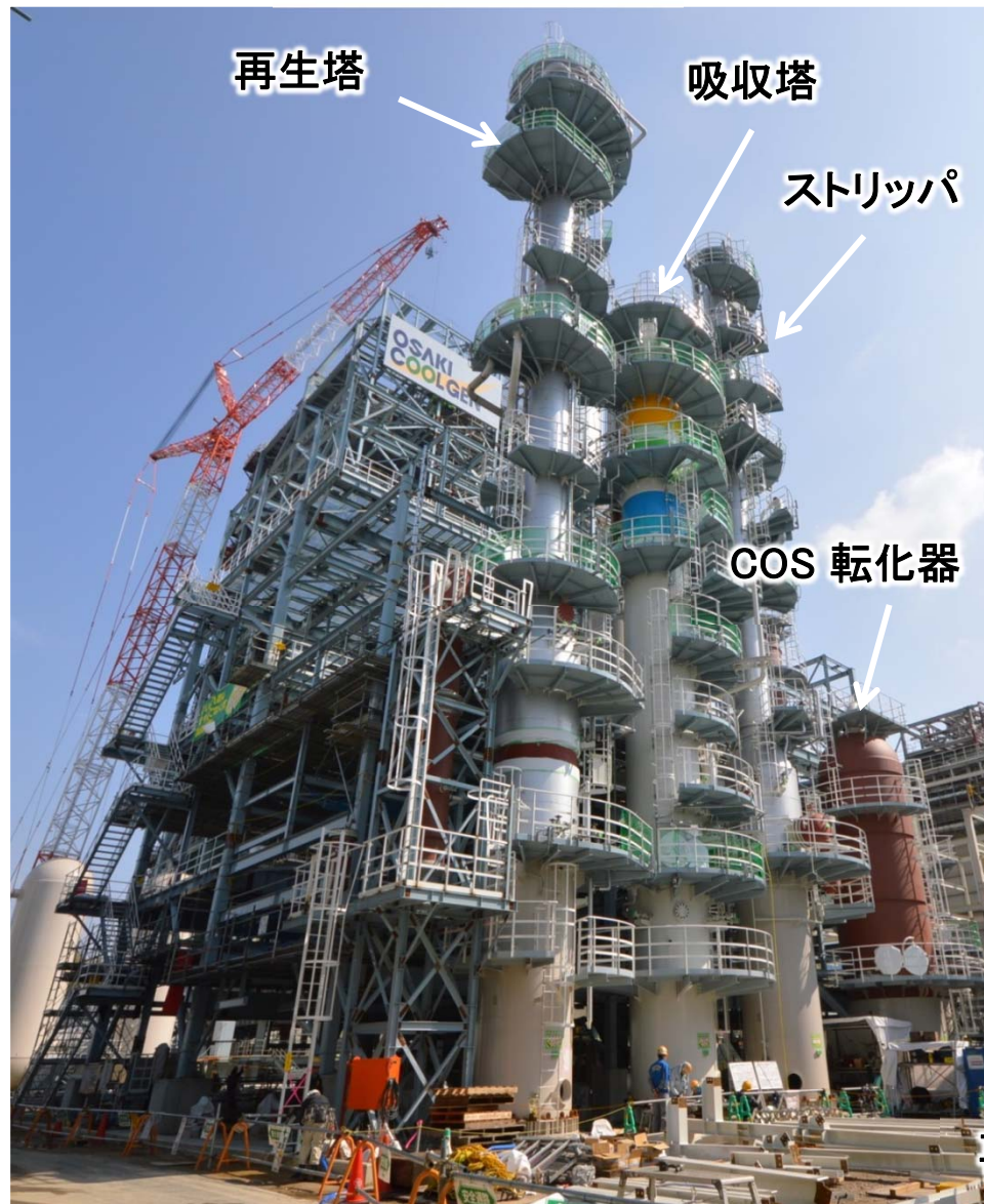
ガス精製設備
