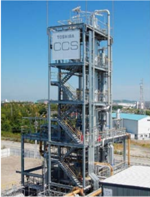
10 t/d規模パイロットプラント (委託:株東芝)
