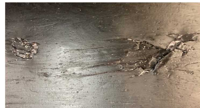
t=3の外観不良例
