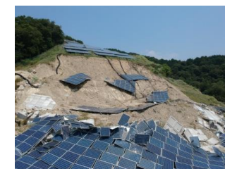
土砂崩れで生じた崩落
