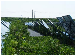
不十分な管理で放置されたパネル
