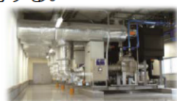
＜中央方式冷凍冷蔵機器＞
