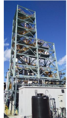
CO 2 分離・回収設備
