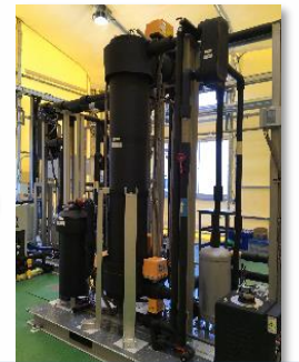
分離回収試験装置
