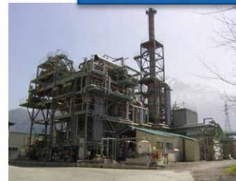
青海工場バイオマス発電設備 (デンカ(株))
