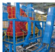
金属破碎・選別設備
