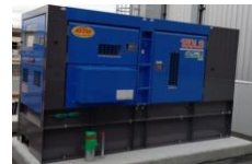
非常用電源設備
