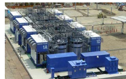
レドックスフロー電池
