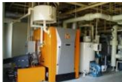
木質バイオマスボイラ
