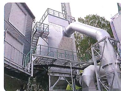
蒸気タービン発電装置
