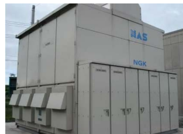
大型蓄電システム施設
