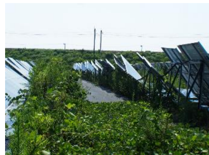
不十分な管理で放置されたパネル
