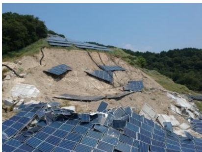
土砂崩れで生じた崩落
