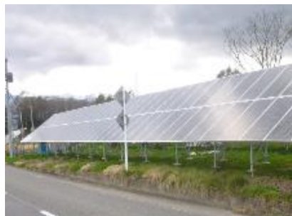
柵塀の設置されない設備
