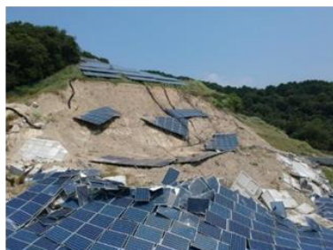
土砂崩れで生じた崩落
