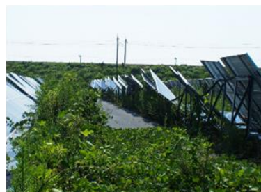
不十分な管理で放置されたパネル
