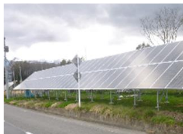
柵塀の設置されない設備
